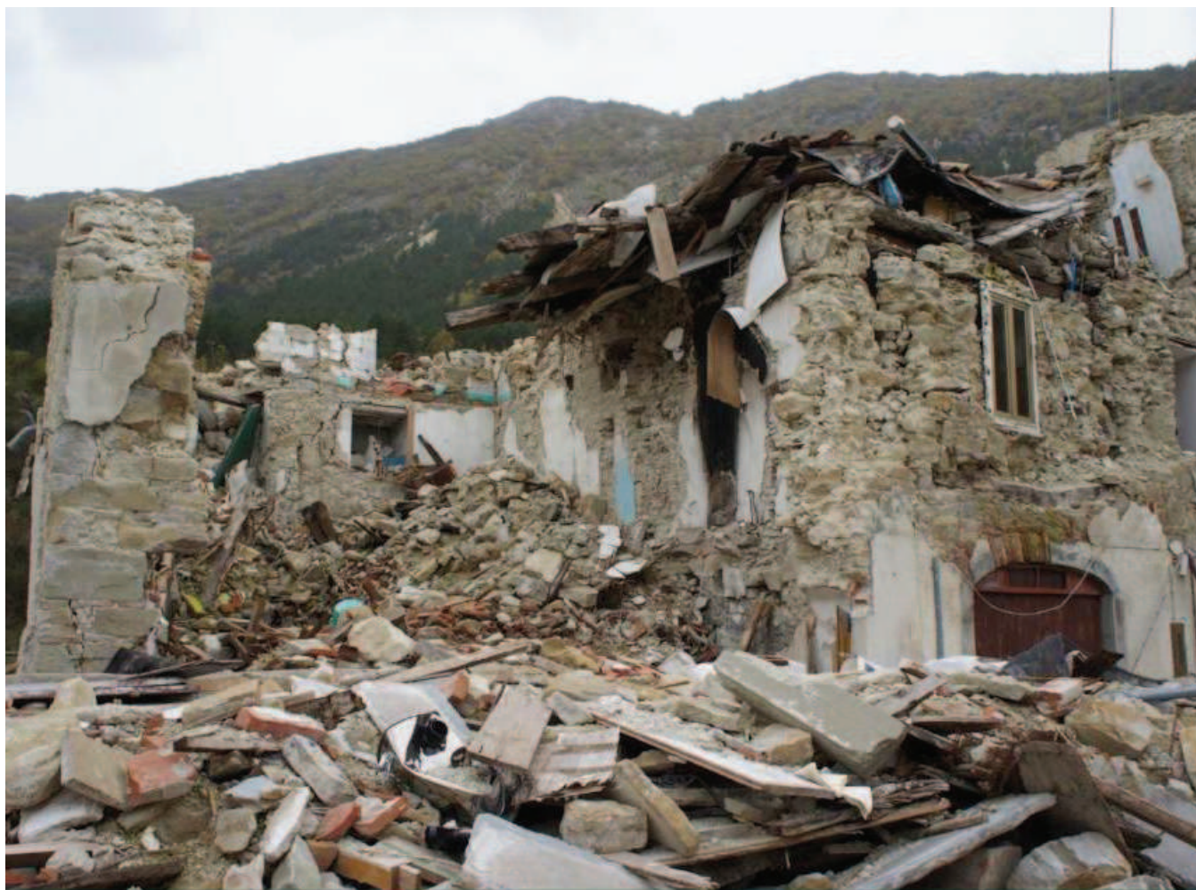
1- Collasso per disaggregazione della muratura
