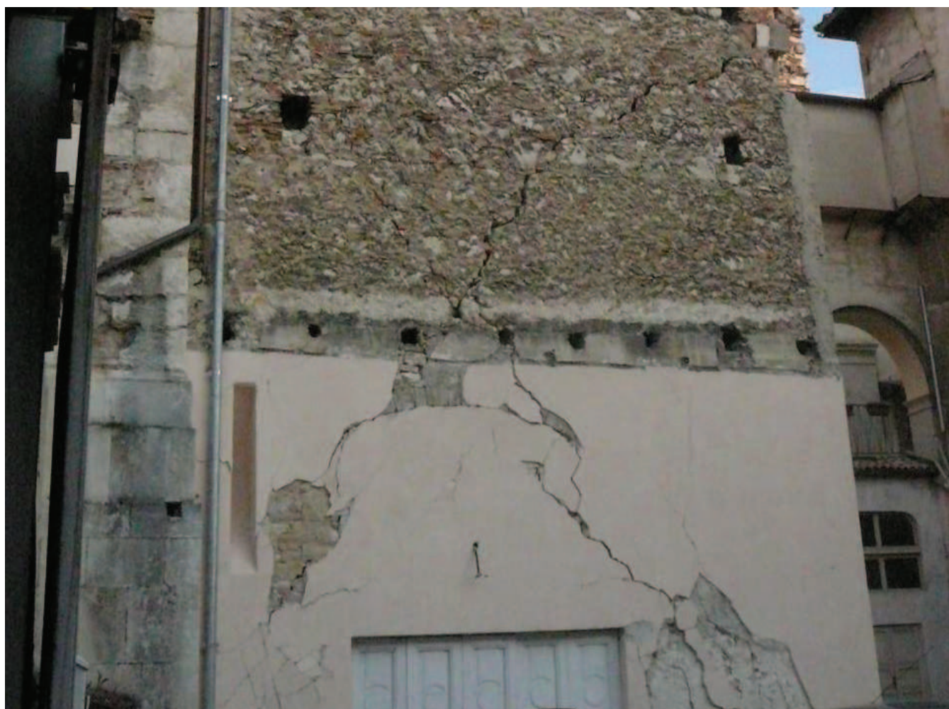
2- Rottura a taglio di pareti murarie
